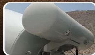
Tanque de Agua
